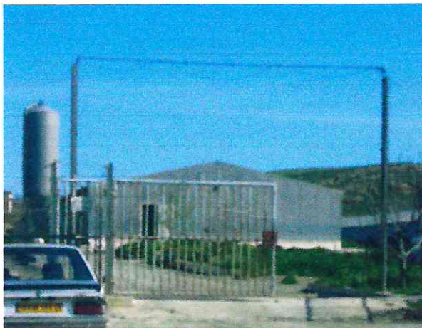
Photo N°26: Système de désinfection
