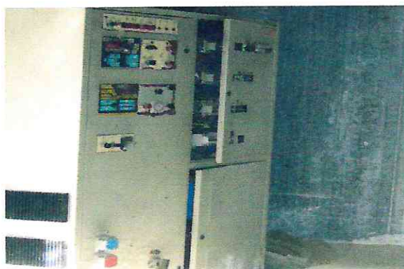
Photo N°31: Armoire de commande
