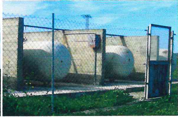
Photo N°23 : Citerne à gaz de propane
