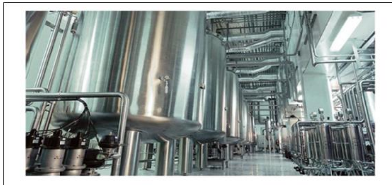
Figure 8: Les bioréacteurs pharmaceutiques
