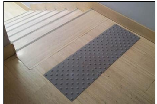
Figure 90: Sécurisation des escaliers Source: handinorme.com
