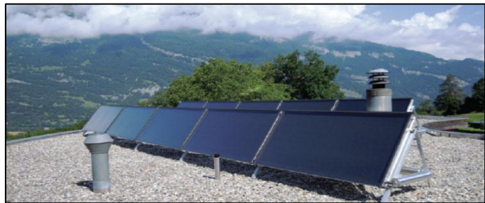
Figure 18: Les capteurs solaires thermiques Source: https://www.romande-energie.ch
