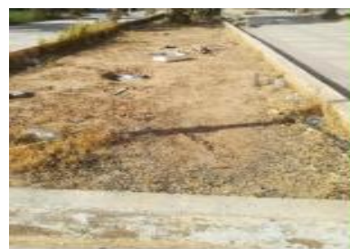
Figure 88 : pelouse non contrôlée. Source : Auteurs.2021
