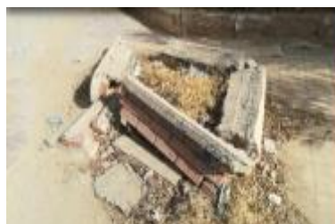
Figure 90 : jardinières cassées Source : Auteurs.2021
