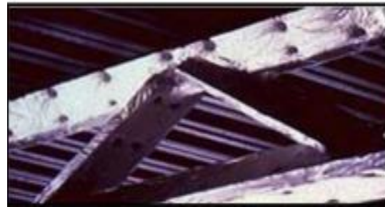
Figure N°= 83 : Charpente protégée par laine minérale
