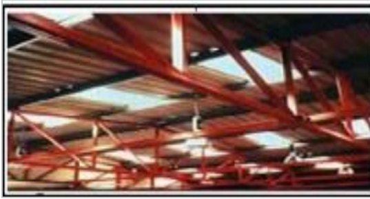
Figure N°= 78 : Protection par peinture intumescentes
