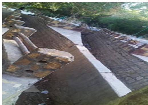
Figure 52: les seguias abandonnées au jardin 5 juillet Source : Auteurs
