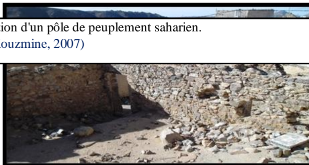
Figure I. 20: Ksar el Mihane en ruine
