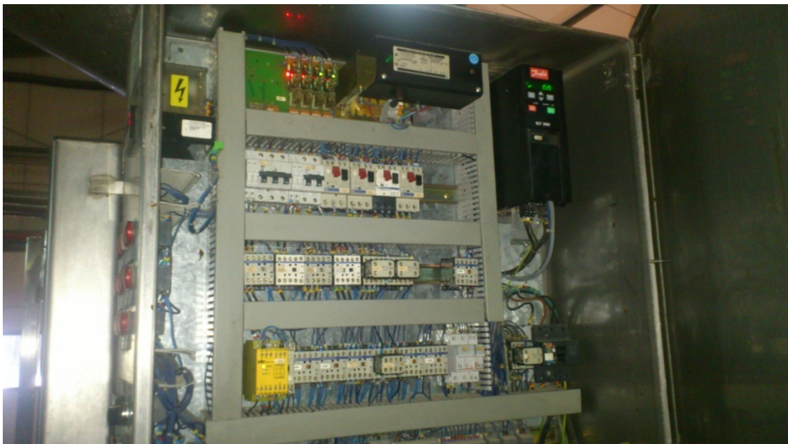
Figure 2.21 : l'armoire (vue interne).
