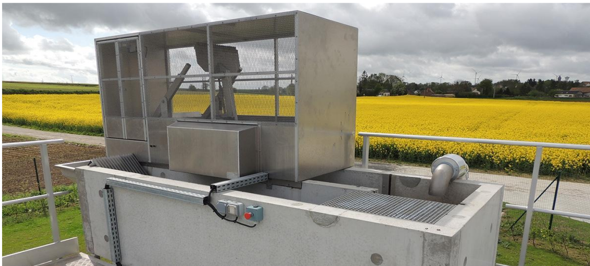
Figure 1. 1: Dégrilleur station d'épuration de Brancourt – AEAP
