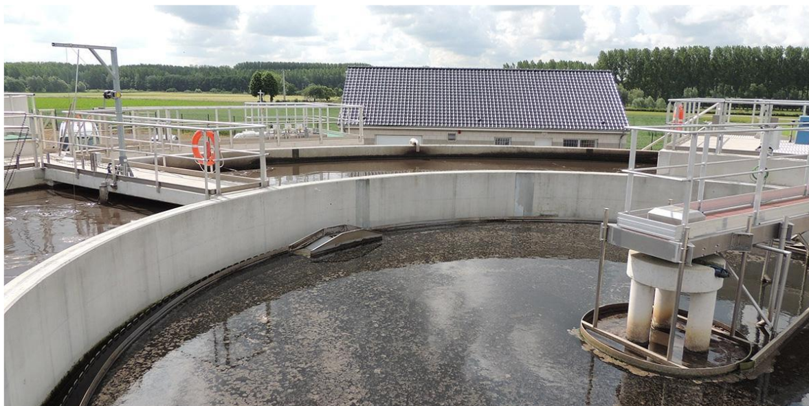
Figure 1. 2: Station d'épuration de Mametz
