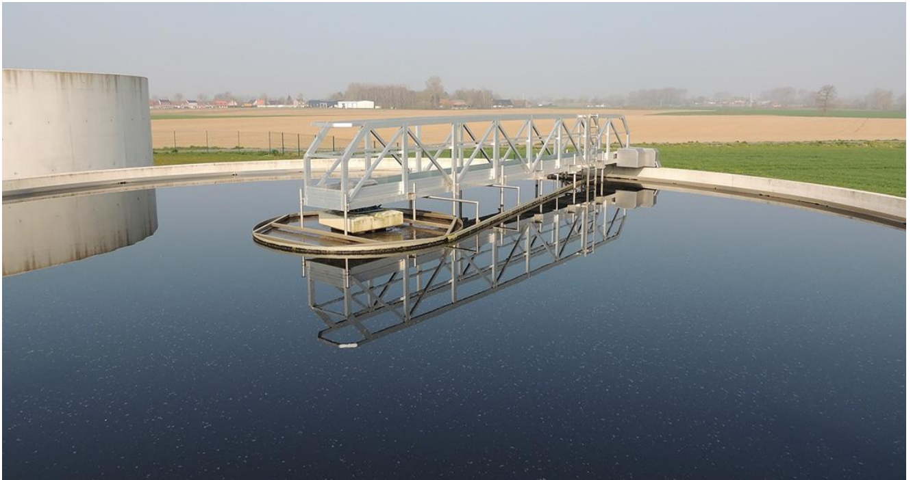
Figure 1. 4: Station d'épuration de Wormhout - D. Devallez
