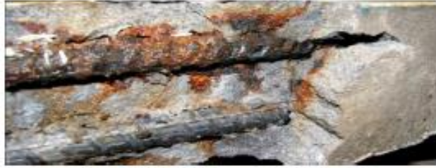
Fig. N°45 : Corrosion du béton armé
