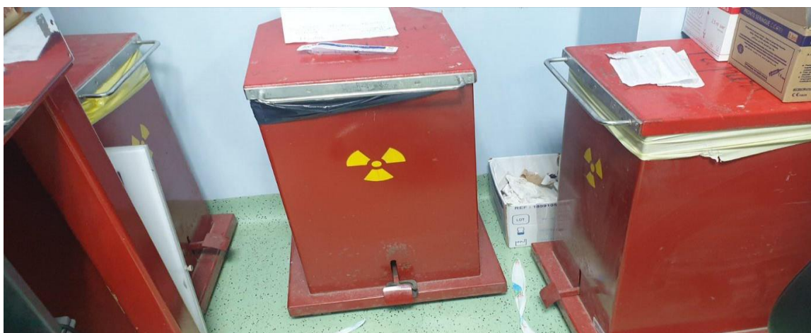
Figure 39 : 3 poubelles plombées du labo chaud : la première pour les gants et papiers, la deuxième pour les seringues et la troisième pour les flacons.
