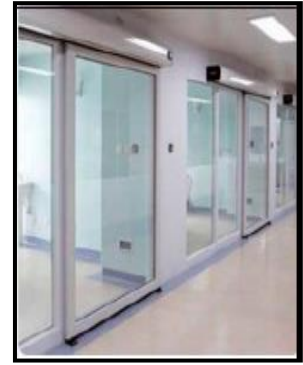
Figure74 :porte coulissante automatique
