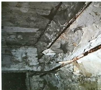
Figure II.18. Les poutrelles métalliques n'ayant pas été traitées anticorrosion ont rompu sous le poids des ans. Source : revue AMENHIS N°17
