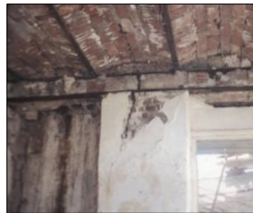
Figure II.19 : Vue sur le plancher à voutains en brique sur poutrelle métallique, des fissures de l'ordre de 5cm dans le mur. Source : revue AMENHIS N°17
