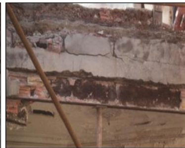
Figure II.20 : Vue sur une poutrelle métallique qui vit ses derniers instants, elle a rempli son office pendant plus de cent ans. Source : revue AMENHIS N°17
