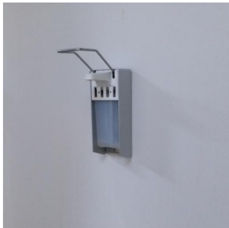
Annexe 05 : Solution hydro alcoolique mise en place au niveau de la salle d'opération (originale)
