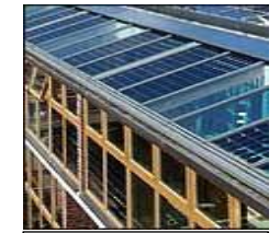
Fig n°52: panneaux photovoltaïques orienté sud
