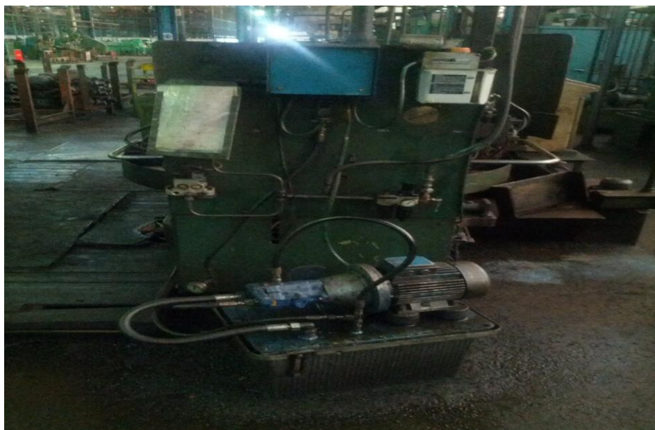
Figure 2.8 : Installation hydraulique et pneumatique.
