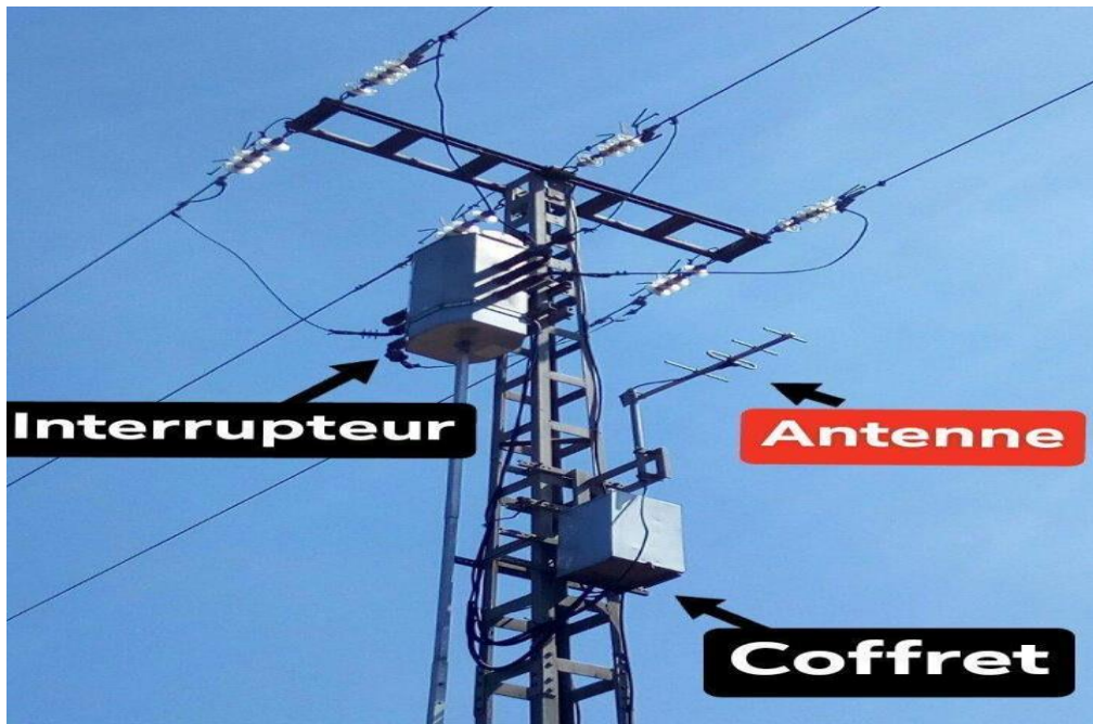
Figure 3-12 Interrupteur aérien IAT Avec coffret installé
