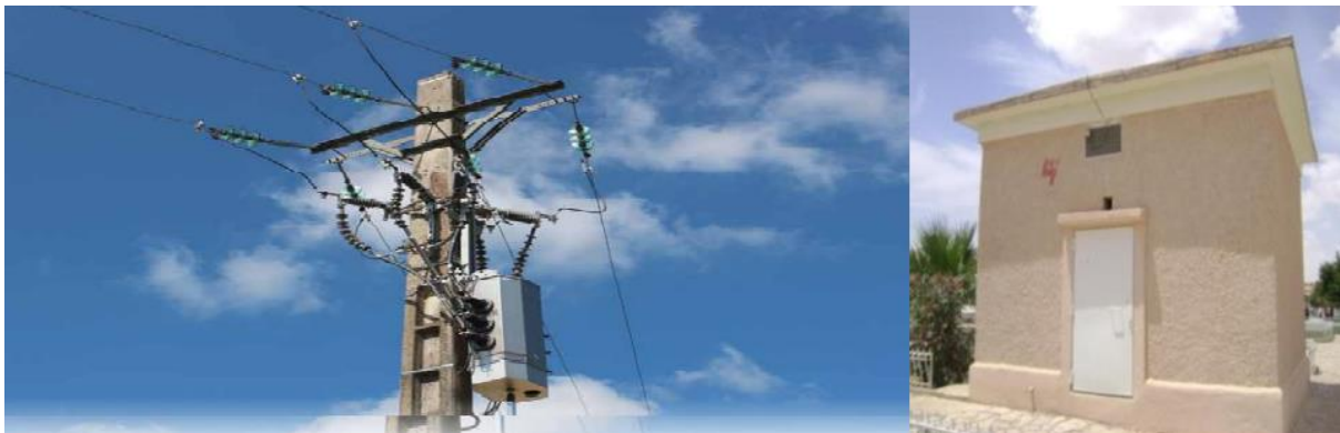
Figure 1-4 Deux type de poste MT/BT
