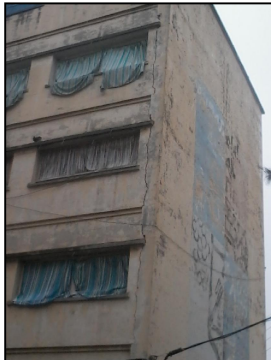
Figure 27 : Des fissures au niveau de la structure
