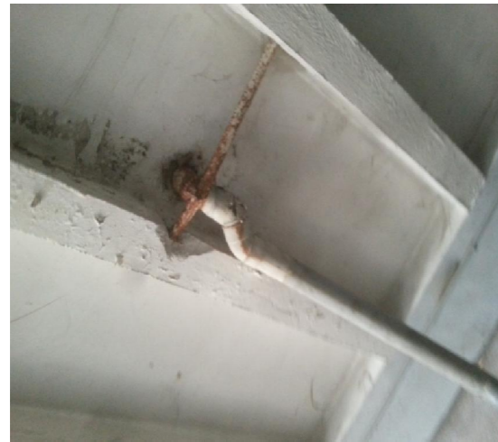
Figure 16: Installation basique en mauvaise état dans le centre commercial
