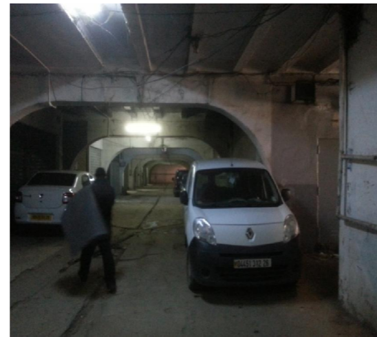
Figure 17: Installation basique en mauvaise état dans le centre commercial
