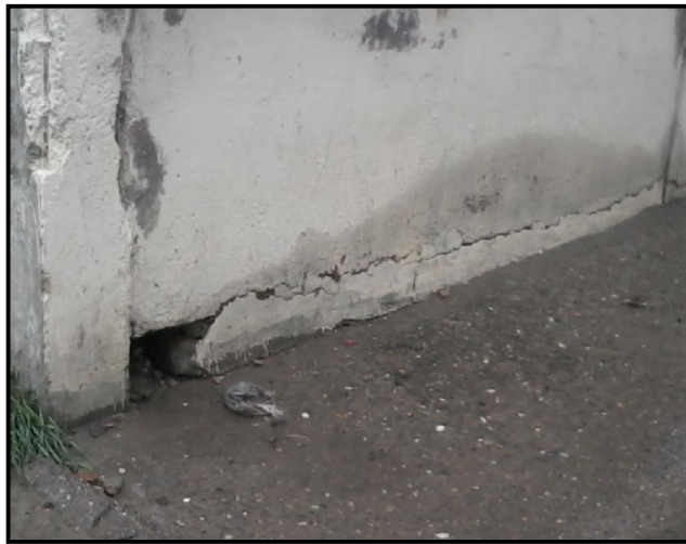
Figure 25 : Des fissures au niveau de la structure
