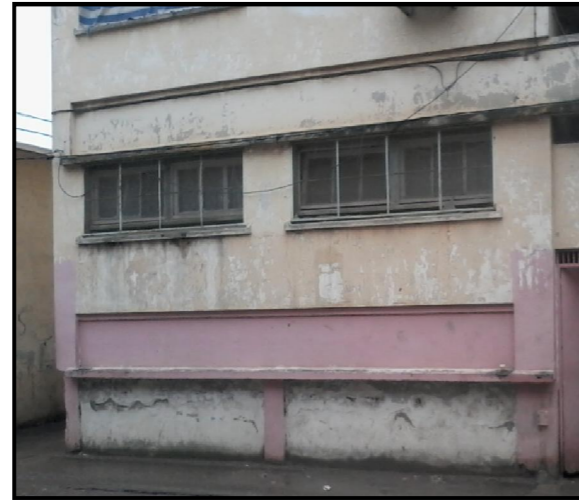
Figure 24 : Des fissures au niveau de la structure
