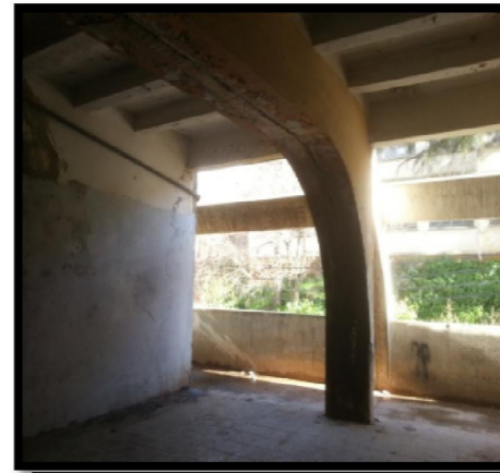
Figure 3.168: Traces d'humidité et d'écoulement
