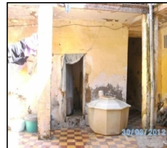
Figure 3.106: la maison est en état dégradé
