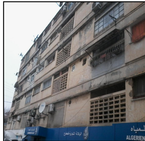
Figure 26 : Des fissures au niveau des murs extérieur
