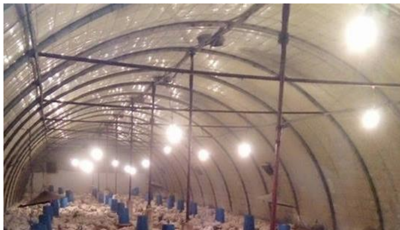
Figure 3.12: installation de system lumineux dans un bâtiment d'élevage.
