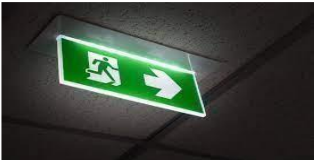
Figure 19: Eclairage de sécurité.
