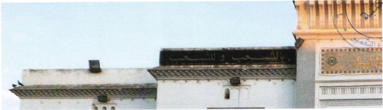
Figure. 3.31 : Vue sur la corniche qui trace le couronnement de la mairie. (Source : Auteur)
