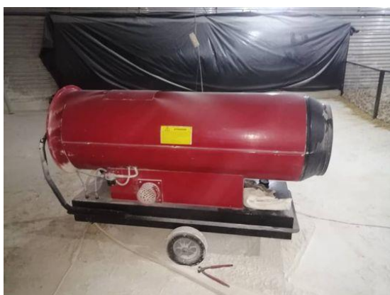
Figure 11: Aérotherme utilisé dans le bâtiment (photo personnelle, 2022).
