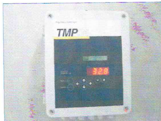
Photo 6: l'ordinateur du contrôle, noté que la température est de 32.8°C.
