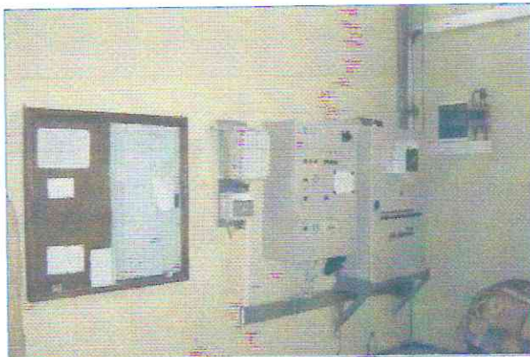
Photo 5: vue du système du contrôle et du tableau de suivi d'élevage.
