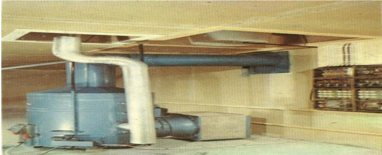
Figure 3 : Chauffage à air pulsé (Solar ; 1983)
