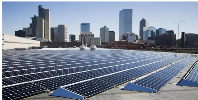
Figure 2.3) : une Installation photovoltaïque sur un toit
