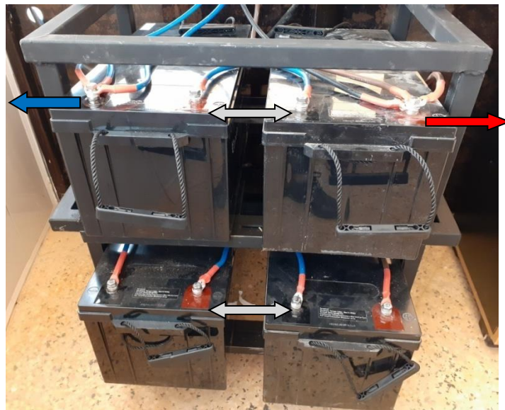
Figure.III.10 : Association des batteries solaire
