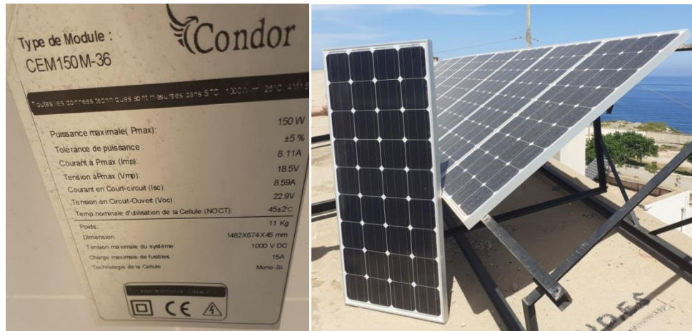
Figure.III.3 : Structure métallique et modules PV installés avec plaque signalétique.
