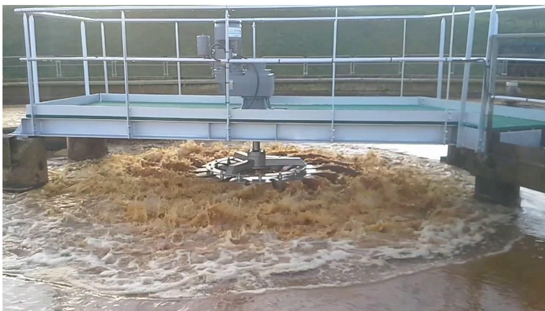
Figure III.12 : Système d'aération « aérateurs de surfaces à axe verticale ».
