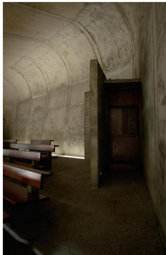
Figure 2.31 : Joints des poutres en béton support de la voûte supérieure. Phot. Paul Barnoud. © Atelier Cairn architectes.
