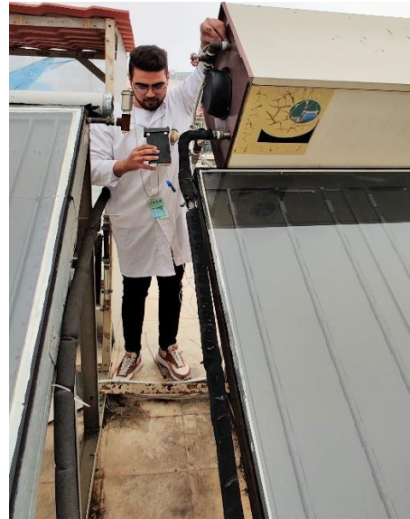
Figure III- 6: mesure de la température à la sortie de la cuve de stockage.
