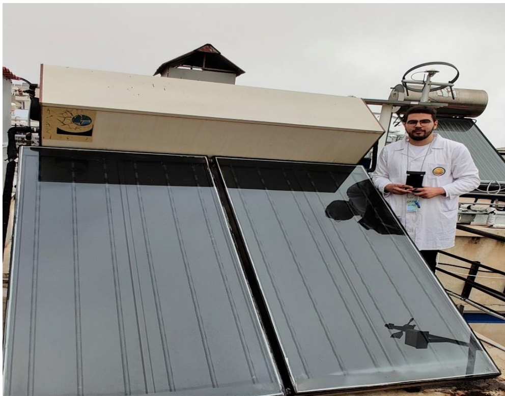
Figure III- 1: Banc d'essai du CESI à BOUZAREAH
