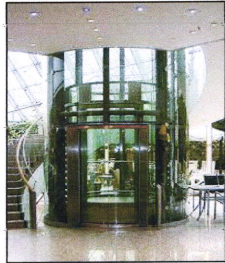
Exemple d'ascenseurs panoramique
