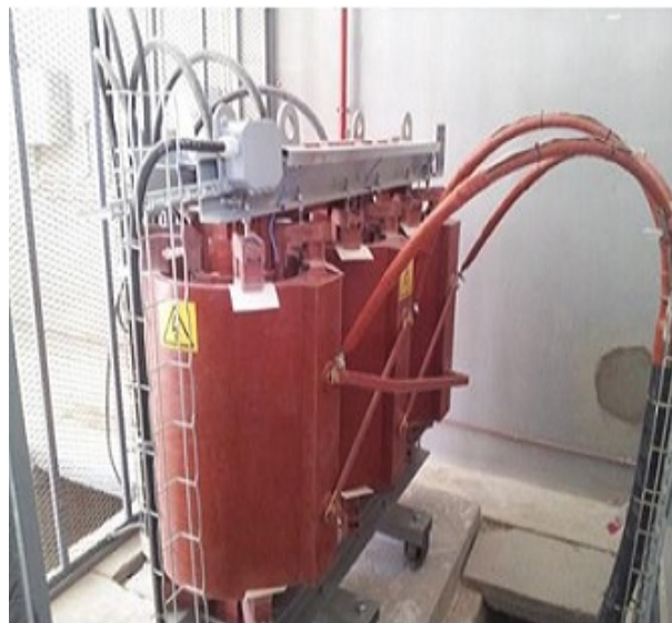
FIG. 2.56 : Le transformateur des systèmes auxiliaires TSA source : document descriptif du transformateur TSA par le Groupement ABB S.P.A. Italie – ABB Algérie SPA
