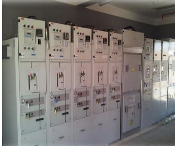
FIG. 2.5 : Le poste de livraison de la centrale PV de Ghardaïa à titre d'exemple.
