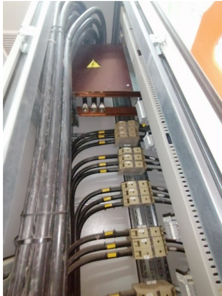
FIG. 2.40 : Jeu de barres pour relier les onduleur (1 2 3 4 5 6) à un Transformateur de puissance. TP1
