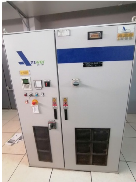
FIG. 2.33 : Onduleur PV8L121 (96 kWc) pour le sous-champ 3 situé dans le bâtiment électrique.
