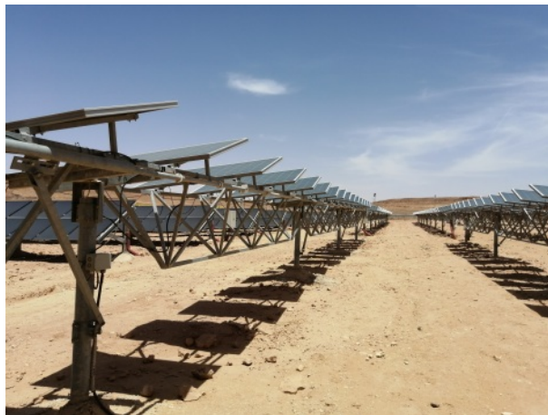
FIG. 2.37 : Deux chaînes de panneaux type Sc-poly sur une structure motorisée.
