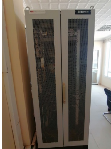
FIG. 2.69 : Armoire du server DCS
