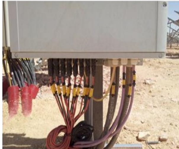
FIG. 2.28 : Les entrées des câbles d'un coffret CC de la centrale.
