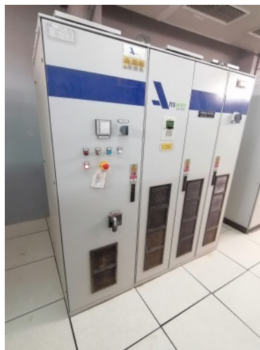
FIG. 2.4 : Exemple d'onduleurs installés à l'intérieur du bâtiment électrique de la centrale PV de Ghardaïa.
