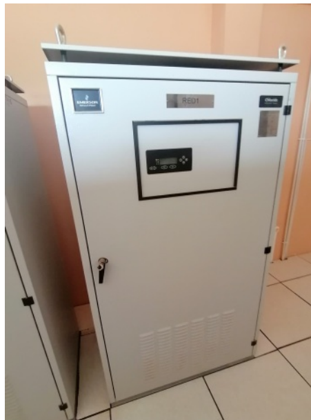
FIG. 2.60 : L'un des redresseur qui ce situe dans le bâtiment de commande.
