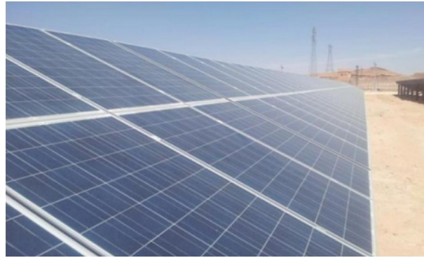
FIG. 2.13 : Panneau Sc-poly à la centrale.
