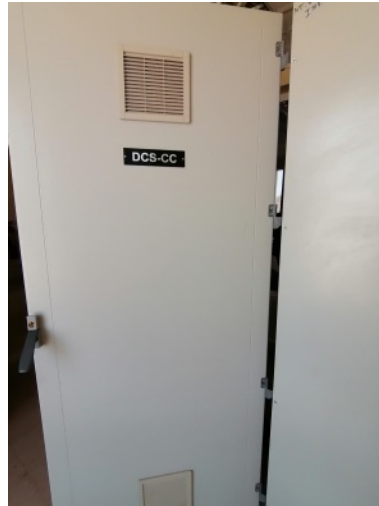
FIG. 2.67 : Armoire DCS-CC (Bâtiment de Commande).
