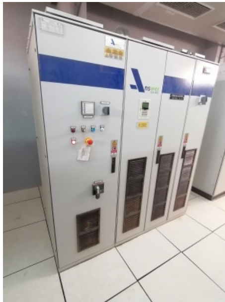
FIG. 2.31 : Onduleur type PV8M291 (250 kW) pour le sous-champ 8 situé dans le bâtiment électrique.
