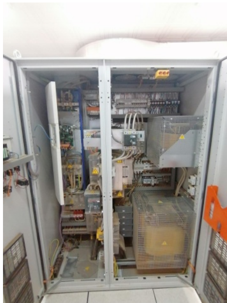
FIG. 2.34 : Vue interne de l'onduleur PV8L121 (96 kWc) pour le sous-champ 3 situé dans le bâtiment électrique.
