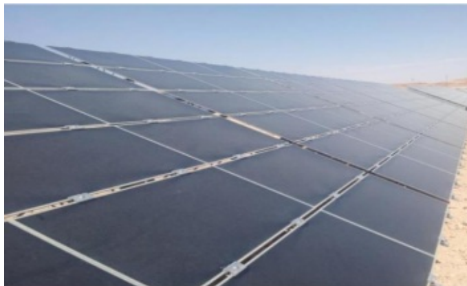
FIG. 2.19 : Panneau FIRST SOLAR « FS-380 ». à la centrale PV.
