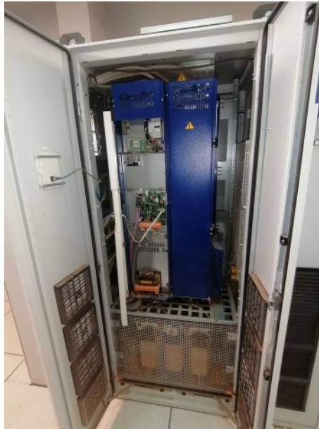
FIG. 2.32 : Vue sur l'intérieur de l'onduleur type PV8M291 (250 kW).
