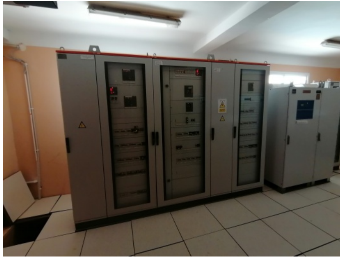
FIG. 2.57 : Tableau generale basse tesnsion au batiment de commande TGBT.
