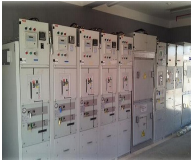
FIG. 2.47 : Tableau moyenne tension TMT au post d'évacuation.
