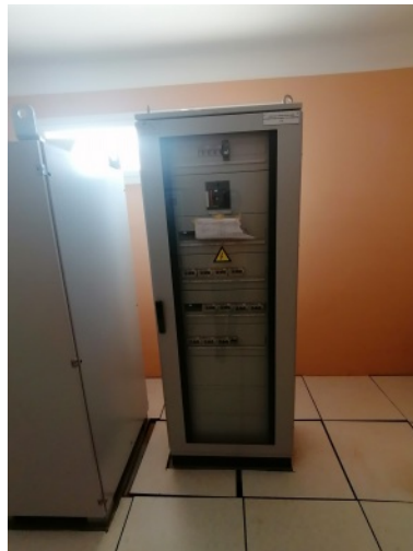
FIG. 2.64 : Tbleau d'alimentation sans interruption au bâtiment de commande.
