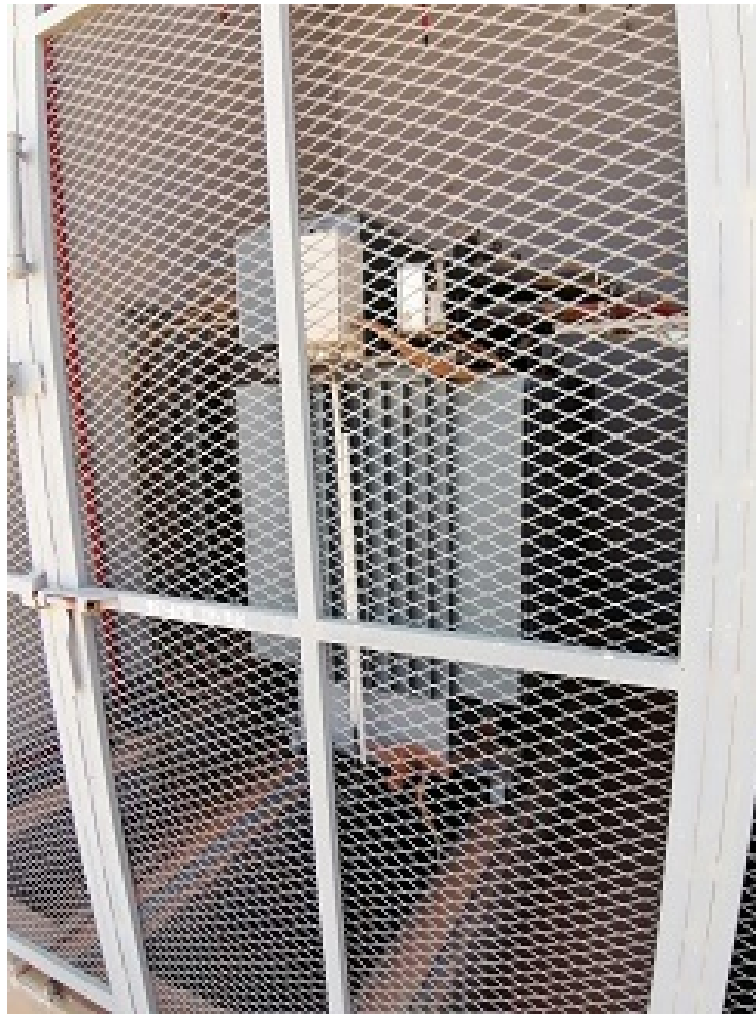
FIG. 2.45 : Transformateur de puissance utilisé dans la centrale.
