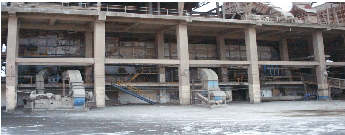
Figure I.16: les ventilateurs de soufflage.
