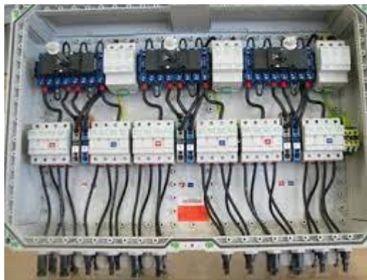
Figure 2-18 : Le boîtier de raccordement [39].
