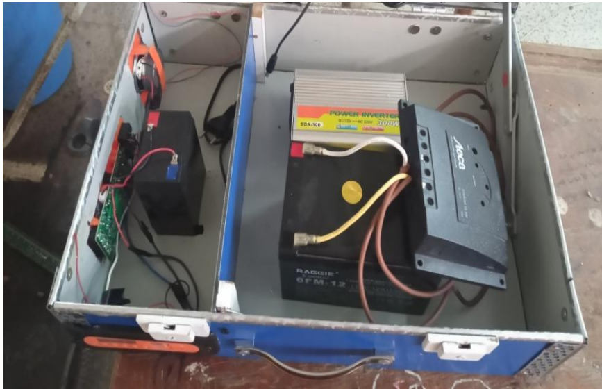
Figure (III-19) : Installation de la batterie, l'onduleur et le régulateur de côté AC.
