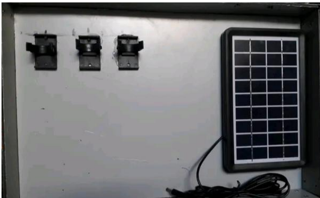
Figure (III-15) : Installation de panneau solaire de côté DC.
