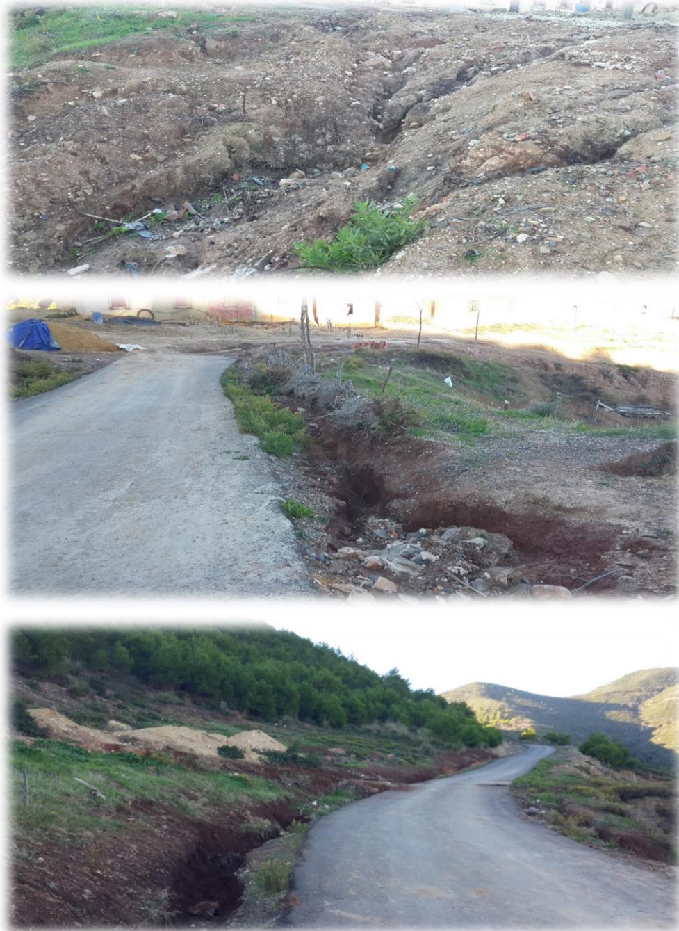
Photo III.3 : Les problèmes des eaux pluviales.
