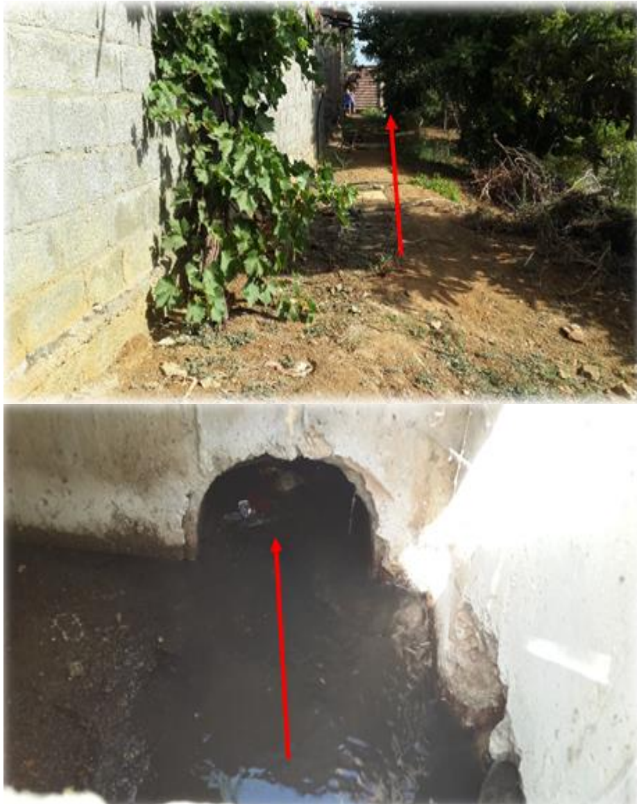
Photo III.1 : Le réseau d'assainissement.
