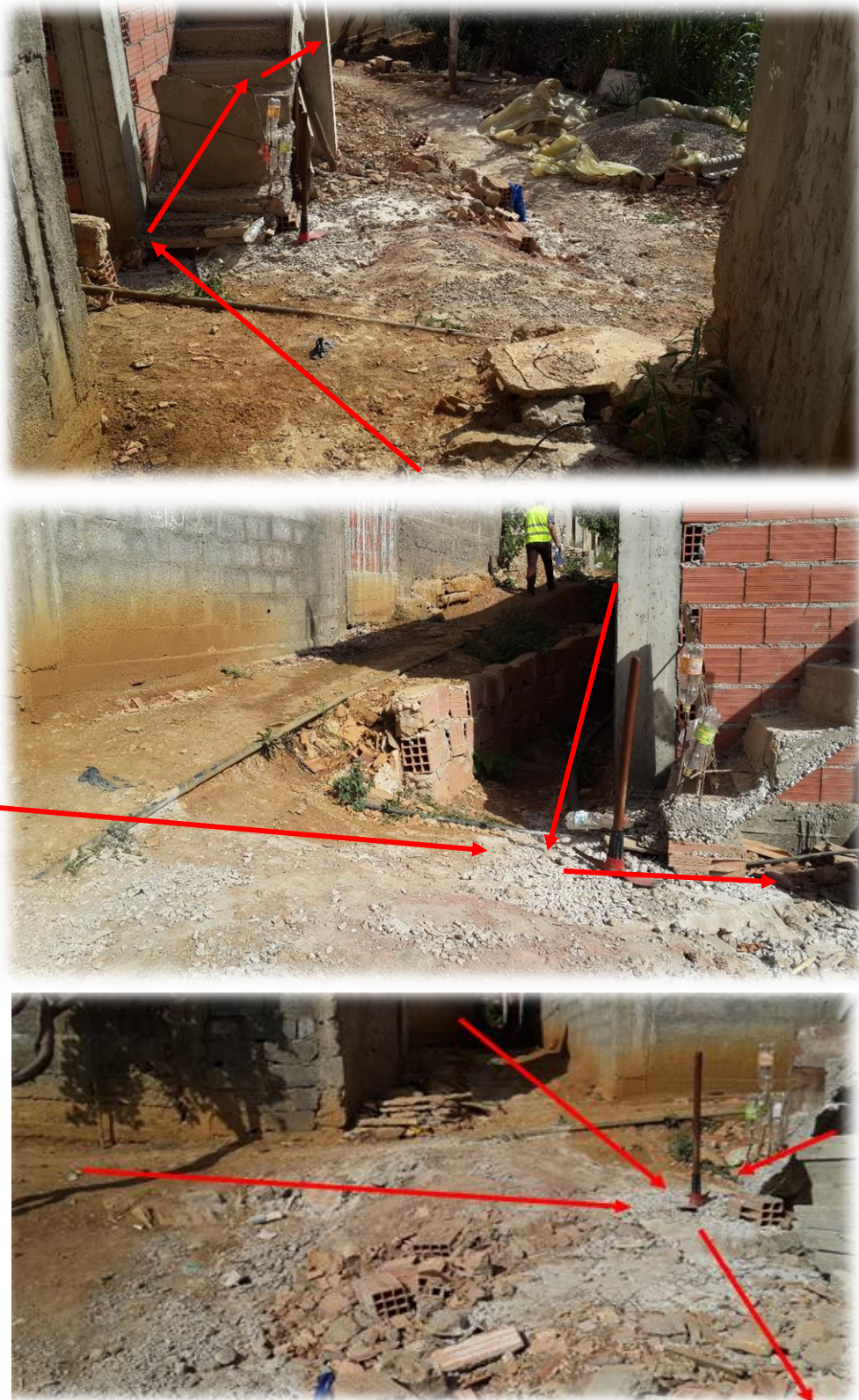
Photo III.2 : Le réseau d'assainissement.
