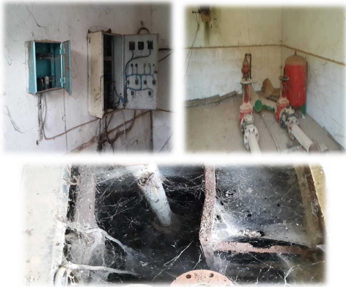
Figure III.3 : L'équipement du poste de relevage.
