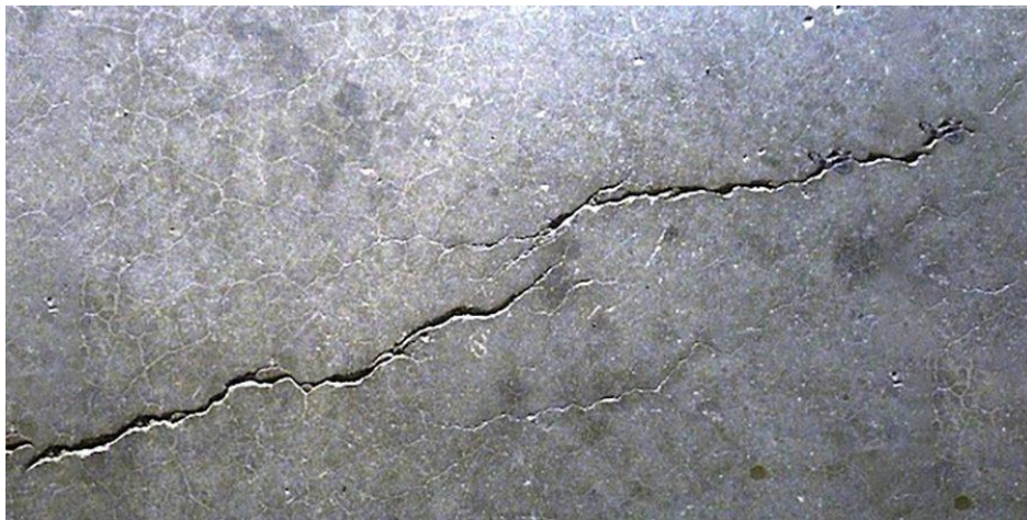
Figure 1.1 : Fissure dans une pièce métallique
