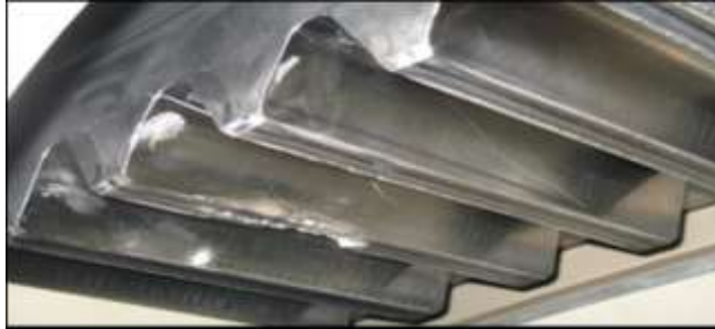
Figure.II.14 : défaut de fissure.[10]
