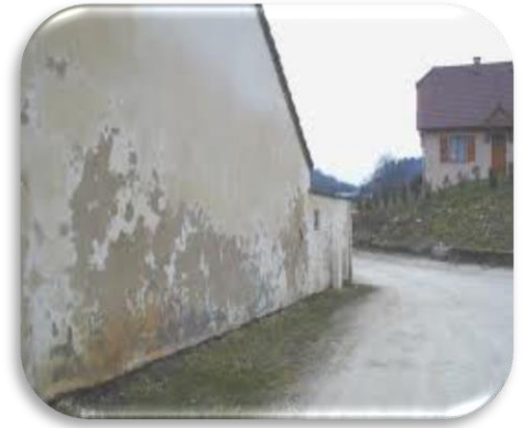
Fig.1. L'humidité sur les façades
