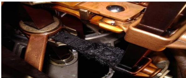
Figure 6: Point chaud sur le sélecteur d'un régleur en charge
