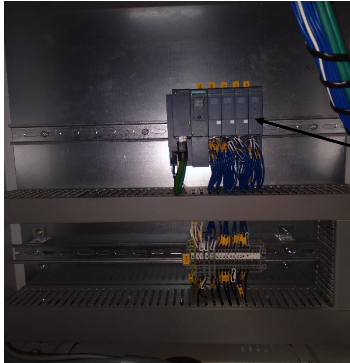
Figure II.42: L'emplacement d'ET200SP dans la seconde armoire de la machine.
