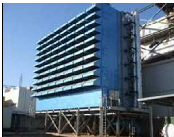
Fig.3 ; La centrale électrique de Hadjret Ennous Tipaza_ source Google image
