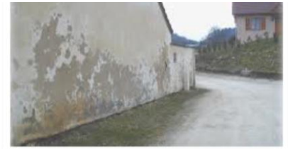
Moisissures sur un mur de clôture, Village de Mirval au sud de la France.
