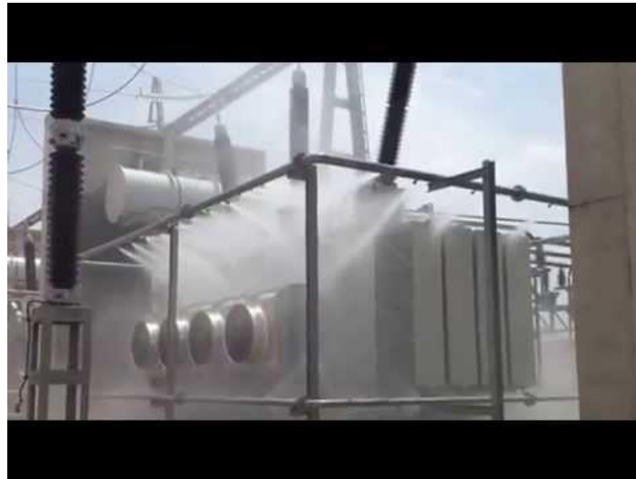
Figure 1-13 Extinction d'un feu dans le transformateur par l'eau. [5]
