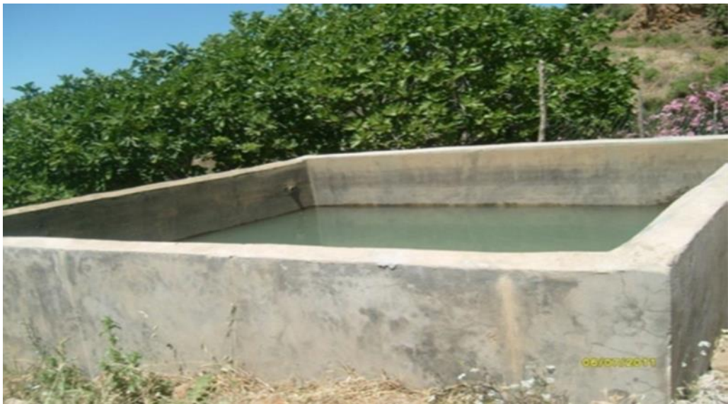
Figure 11: point d'eau aménagée (CFB, 2016).
