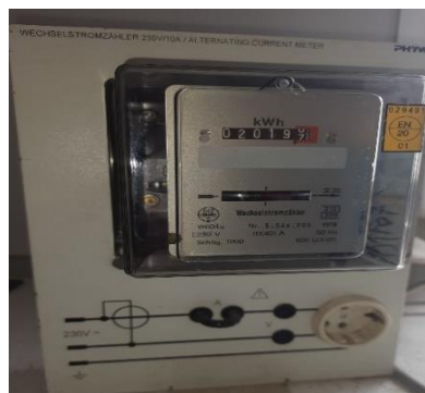
Figure 26. Photo de compteur électrique utilisée.
