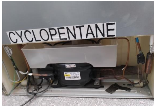
Figure 22. Le compresseur du réfrigérateur.
