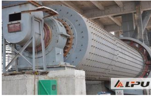
Figure I.6. Broyeur à boulets ducru de la cimenterie
