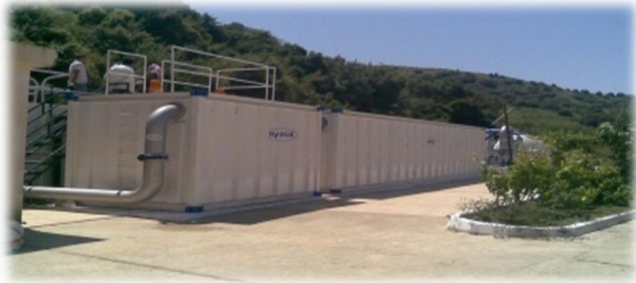
Figure 07: Station de traitement de Sidi Aissa (Photo originale).
