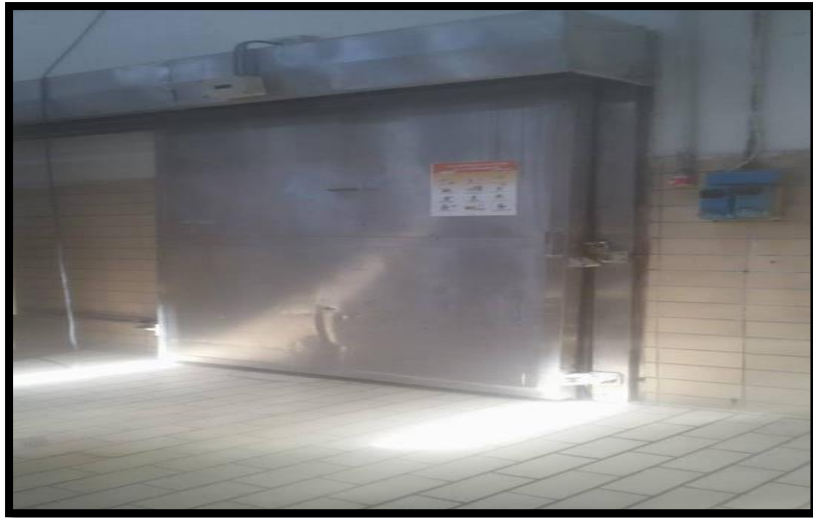
La chambre froide 6°C
